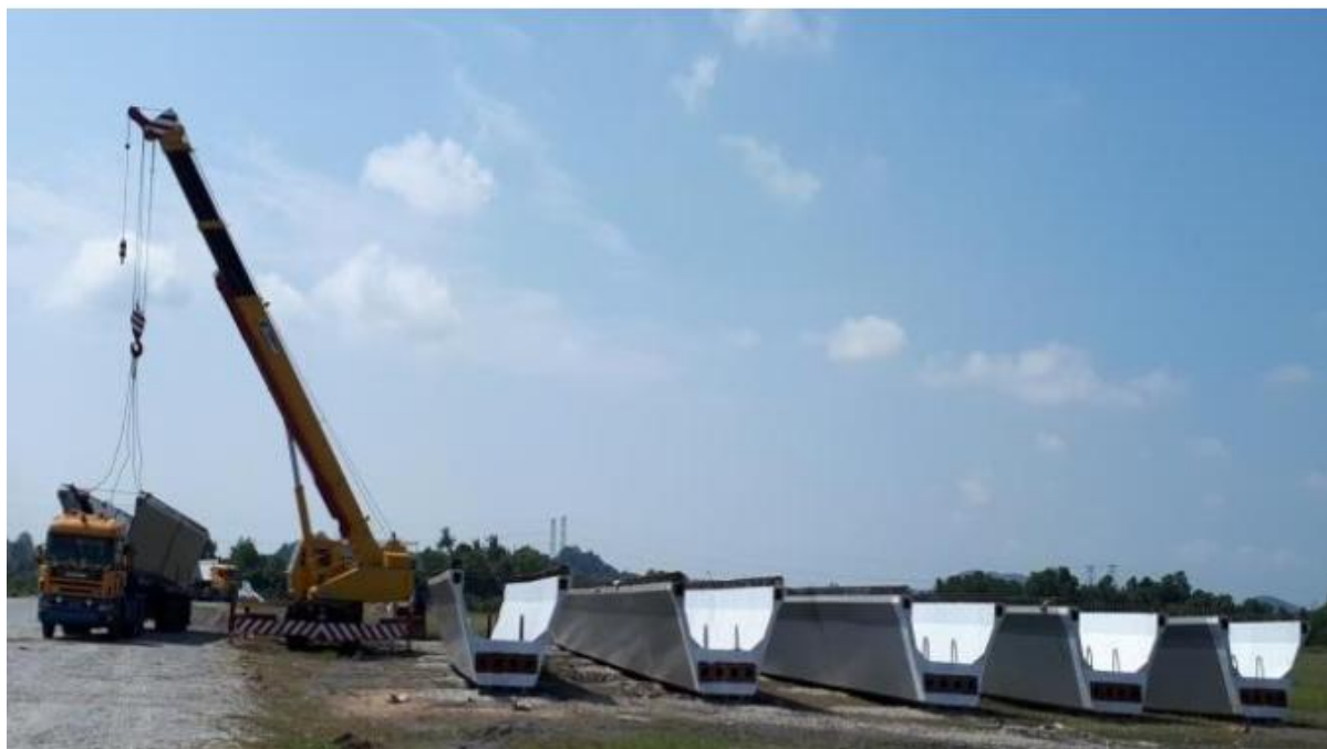
شکل ۱۲- انتقال قطعات پیش ساخته و ساخت تیر دهانه ۳۸ متری با جرثقیل ۴۵ تنی
