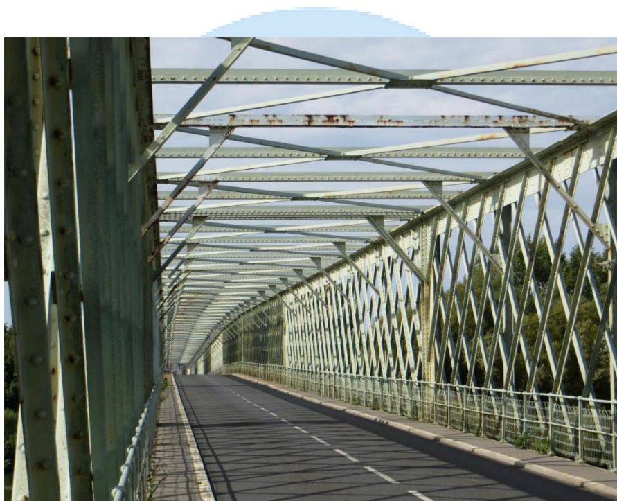
شکل ۲۶ - پل Thouré-sur-Loire قبل از تعمیر و تقویت با رویه‌ی آسفالتی [۳۳].
