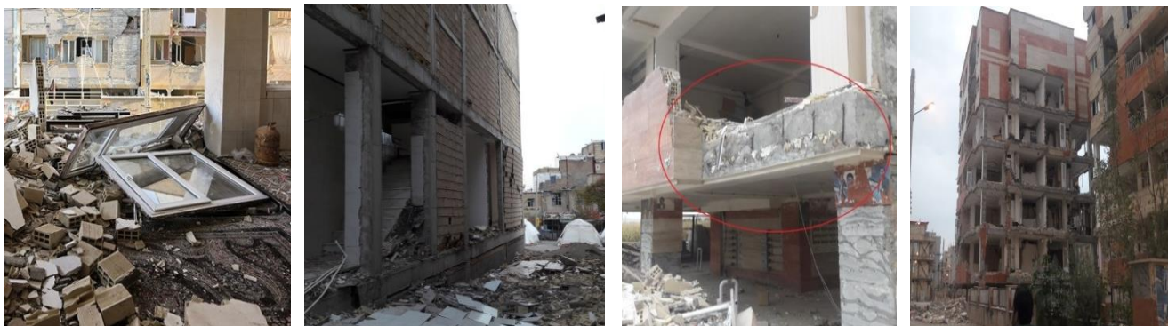
شکل ۳: عدم مهار مناسب میان‌قاب‌ها و اجزای غیرسازه‌ای و آسیب‌های آن در زلزله ۲۱ آبان ماه کرمانشاه ۱۳۹۶
