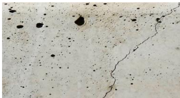
شکل ۲- ترک‌های میکرو در بتن
