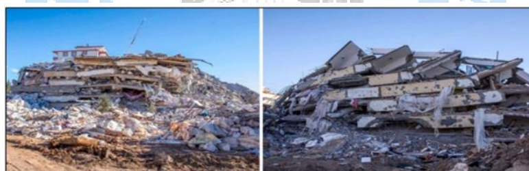
ب: فروریزش کامل سازه بتنی در زلزله ۲۰۲۳ ترکیه
