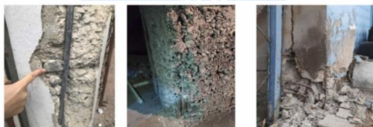
الف: خرابی ستون‌ها ناشی از ضعف مقاومت بتن در زلزله ۲۰۲۳ ترکیه
