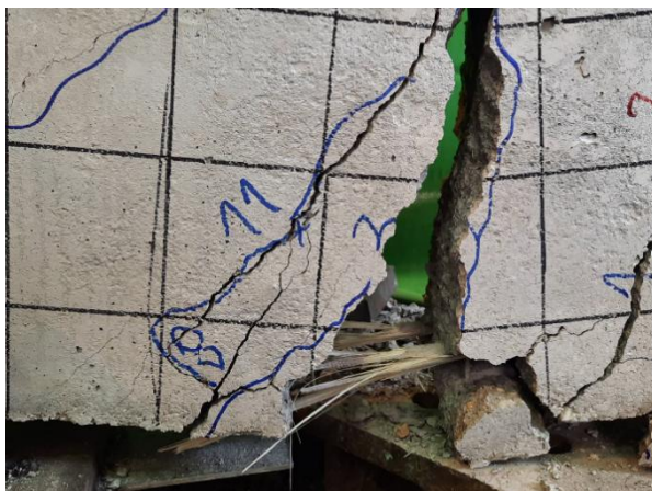
شکل 15: گسیختگی میلگرد GFRP بر اثر تحمل بار در نمونه NIH0
