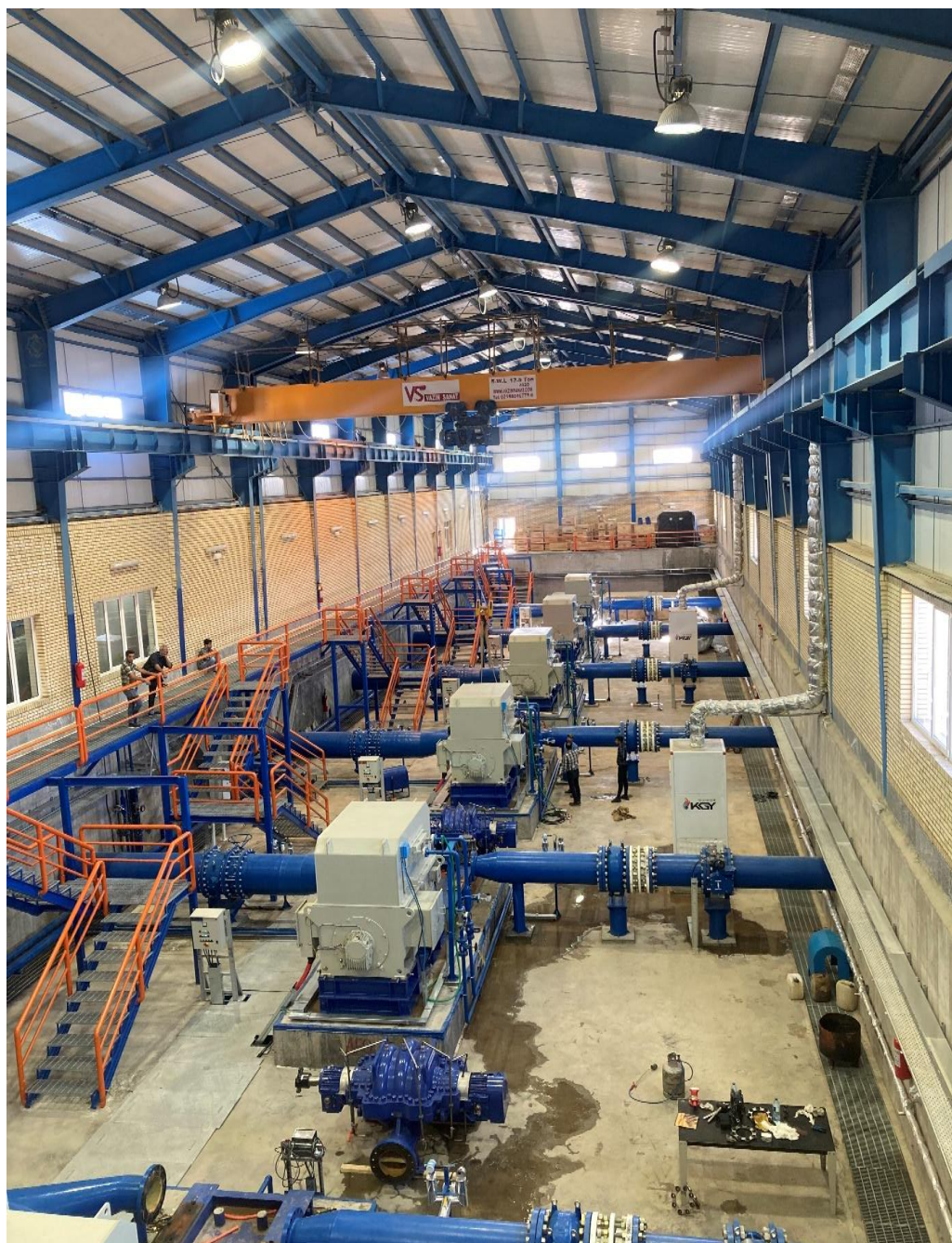
شکل ۲- ایستگاه پمپاژ شماره ۳ از قطعه دوم از طرح انتقال آب خلیج فارس به صنایع جنوب شرق کشور
