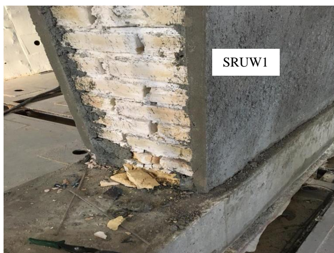
شکل ۱۹: در نسبت جابجایی ۰/۳۱۲٪ خرد شدن آجر پاشنه.
