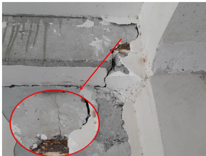
شکل ۷: ترک ایجاد شده در ناحیه اتصال تیر به ستون ساختمان پیش ساخته دیسمان در زلزله بجنورد [۱]
