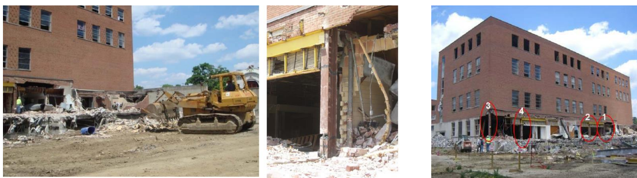
شکل ۱۰: ساختمان اتحادیه دانشگاه اوهایو و محل ستون های حذف شده [۲۳]
