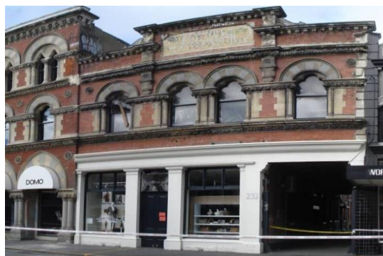
شکل ۱: برخورد دو ساختمان مجاور در زلزله نیوزلند در سال ۲۰۱۱ [۵]
