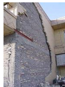
شکل ۱: فروریختن نمای آجر سه سانتی به علت نداشتن اتصال مناسب به میانقاب آجری [۲].
