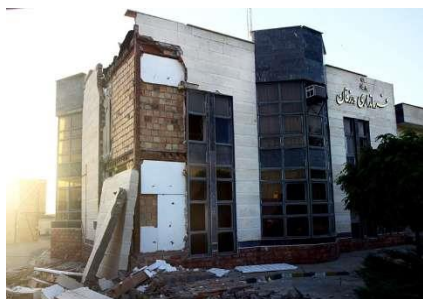
شکل ۲: آسیب به نمای سنگی فرمانداری ورزقان به علت عدم مهار مناسب قطعات سنگ نما به میانقاب سفالی [۳].
