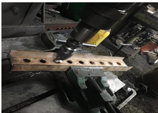
شکل ۶: پخ زدن لبه سوراخ‌ها به منظور جلوگیری از تمرکز تنش در لبه‌های سوراخ‌ها
