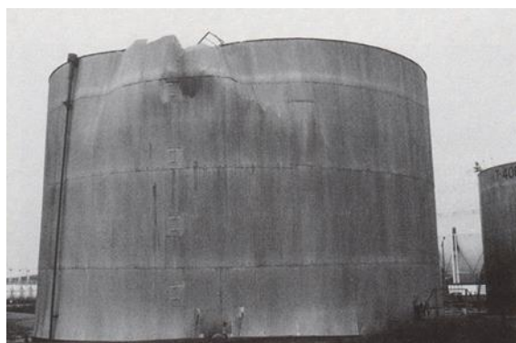
شکل ۱: نمونه خرابی مخازن تحت اثر نیرو زلزله
