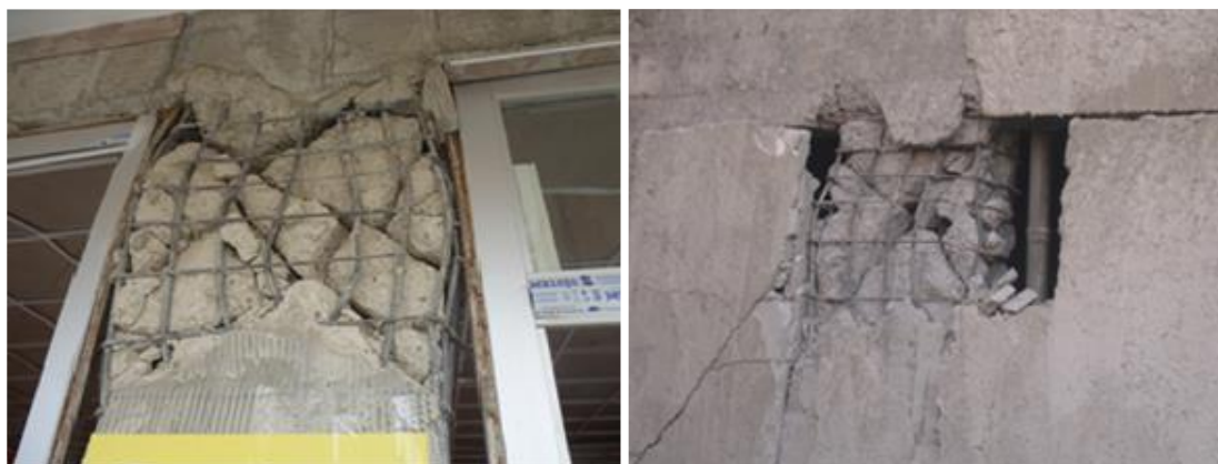
شکل ۱: شکست برشی ستون‌های کوتاه بتن مسلح [۳]
