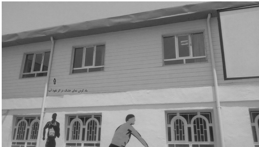
شکل ۶: باد کردن نمای خشک در اثر نفوذ آب.
