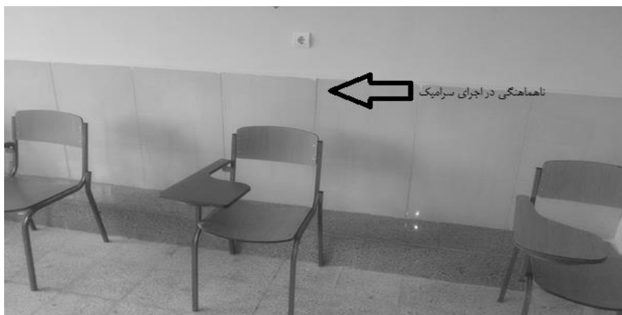
شکل ۲: اجرای ناهماهنگ سرامیک چسبی.
