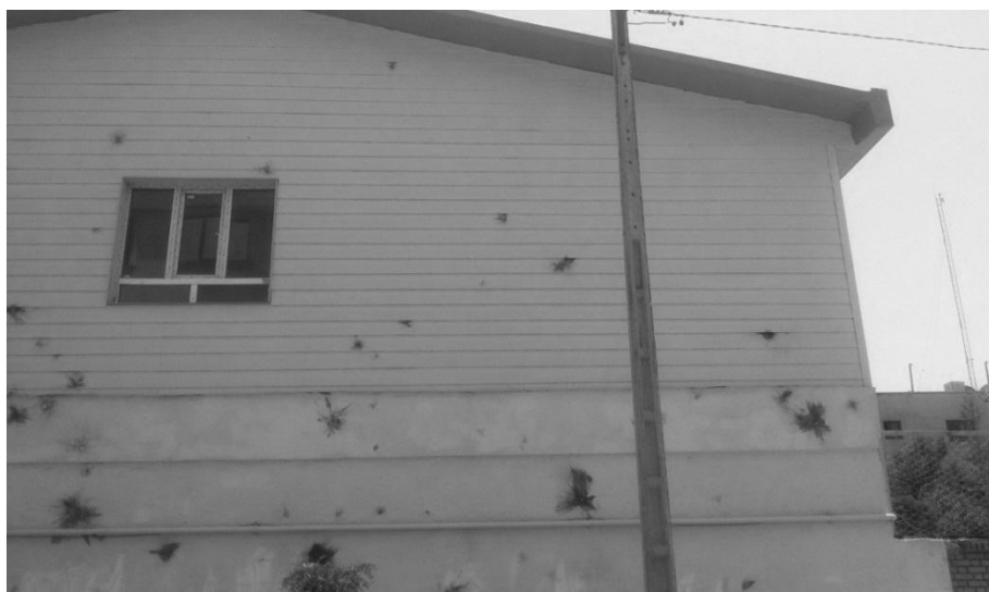
شکل ۷: تخریب نمای خشک در اثر برخورد مواد منفجره.
