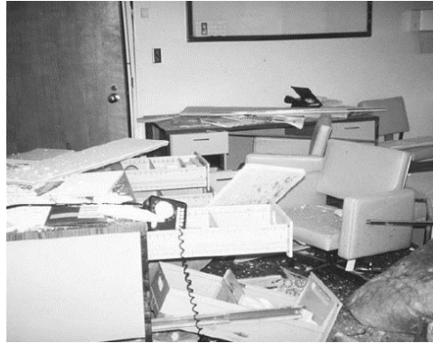
شکل ۲: خسارات وارد به اجزای غیرسازه‌ای ساختمان در زمین لرزه [۱].
