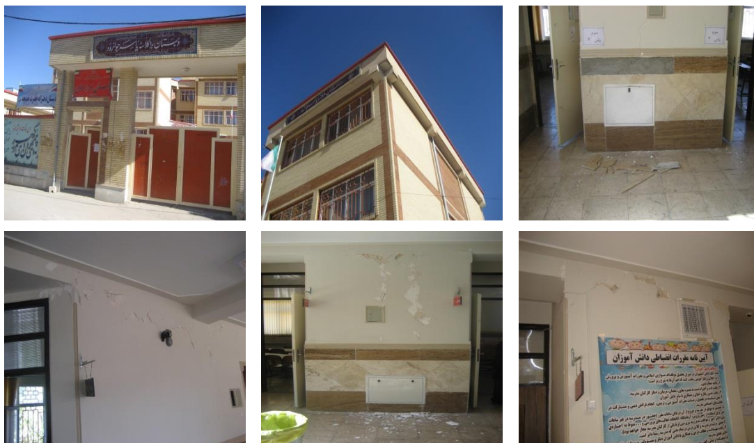
شکل ۱۳: مشاهدات پس از زلزله آبانماه ۱۳۹۶ کرمانشاه و آسیب های اجزای غیر سازه ای در نمونه ای از تیپ مدرسه مورد مطالعه
