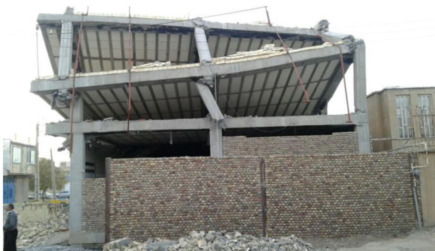
شکل ۱: وقوع آسیب در ناحیه اتصال و ستون بعد از زلزله سرپل ذهاب ۱۳۹۷.
