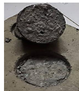
الف) نمونه با پوشش محافظ ملات ماسه سیمان حاوی چسب، گسیختگی در بتن بستر
