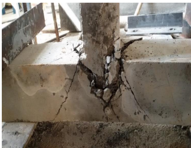
شکل ۸: حالت شکست پیچشی بتن با ۰/۵ درصد الیاف
