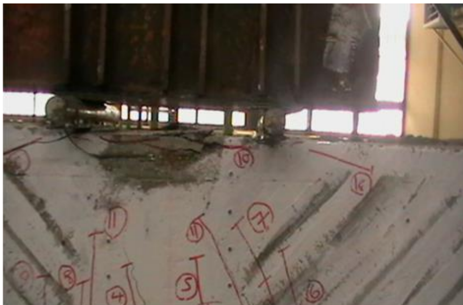
شکل ۱۲: نحوه ترک خوردگی و شکست تیر B- N
