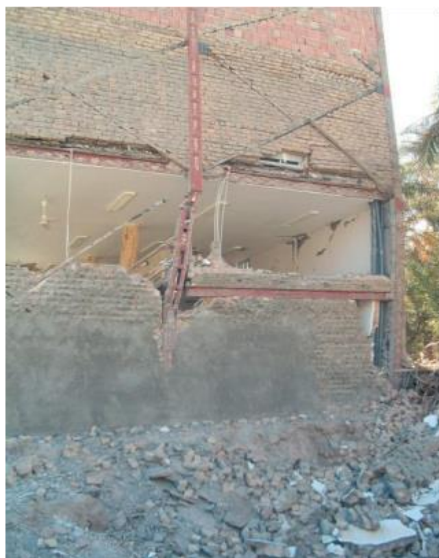
الف) آسیب ایجاد شده در ستون ناشی از میان طبقه ساختمان یک‌جهت مهاربندی در زلزله بم
