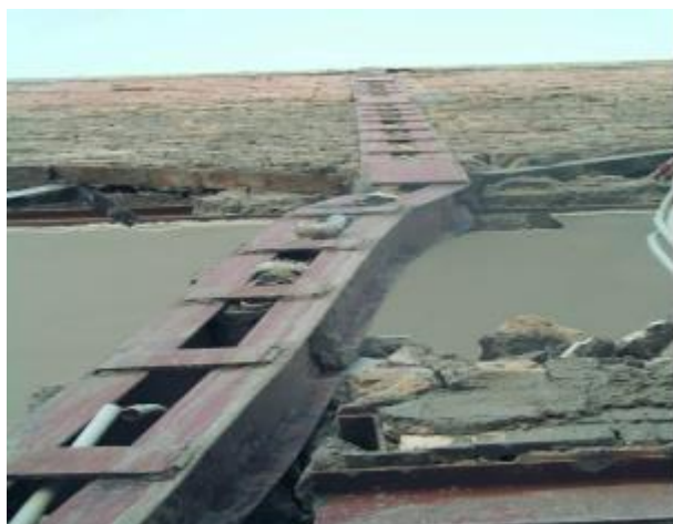
ب) گمانش ستون ساختمان یک‌جهت مهاربندی در زلزله بم
