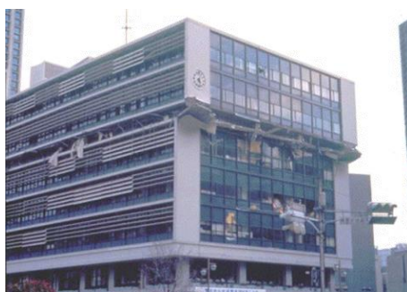
شکل ۱: انهدام طبقه پنجم ساختمان در زلزله کوبه، ژاپن، ۱۹۹۵ [۱]
